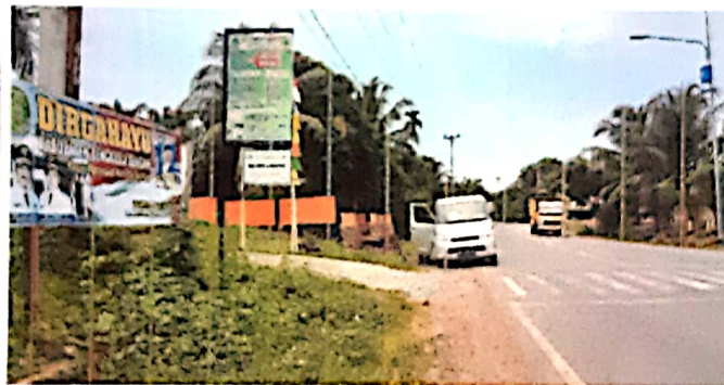
Kondisi Jalur pipa distribusi depan jalan masuk Puskesmas Desa Ujung Karang Kec. Karang Tinggi
